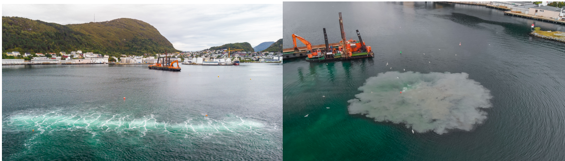
Bilder fra testinstallasjon Kystverket Ålesund – måling av funksjon og trykkdemping. Boblegardin 3,6 l/s/m
